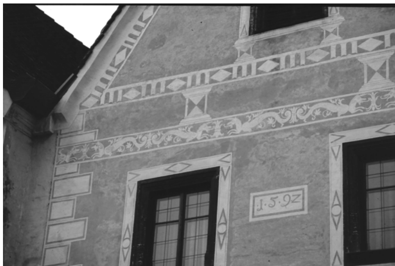
Abb. 424: Steyr, Stadtplatz 19, Eckquaderung und Fensterumrahmung
