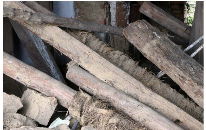
Abb. 13 Lehmstecken (das sind strohumwickelte Holzbalken; im regionalen Dialekt: „Loamsteka“) wurden nach Teileinsturz einer Decke über dem Erdgeschoß in einem Vierkantrohof in Schleissheim/OÖ sichtbar.
