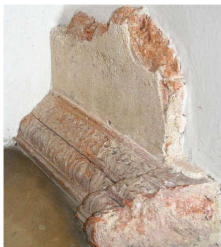
Abb. 31 Detailaufnahme eines der verbliebenen Felder originaler Wandverkleidung im Weißmarmorsaal (Foto 2019).
